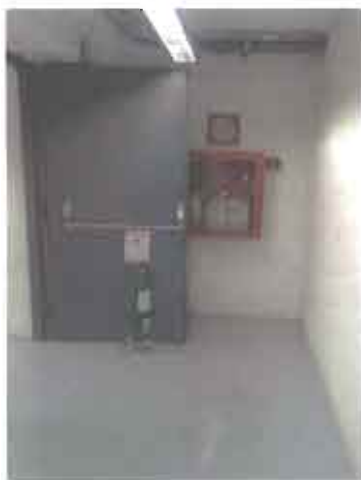
Foto 37: Extintor de agua en áreas de archivo.
