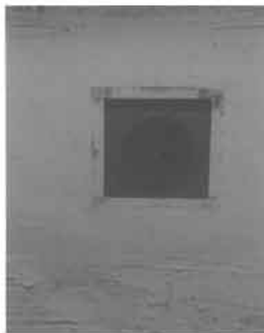
Foto 40: Ducto de ventilación en depósitos
