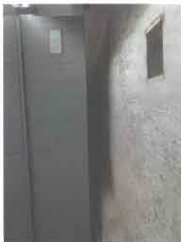
Foto 38: Humedad de piso a techo en depósito.
